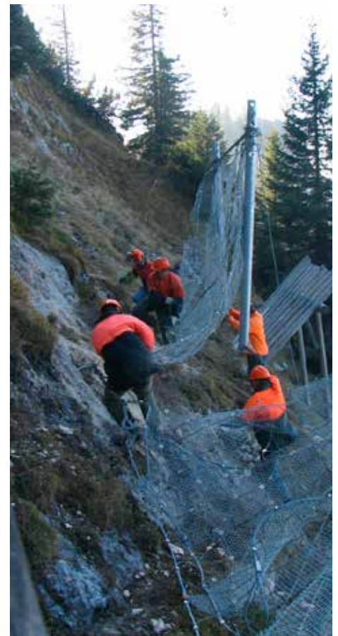
Nix für Warmduscher. Das Installieren von Lawinennetzen erfordert vollen Einsatz der Fünf von der Fachstelle Schutzwaldmanagement.
